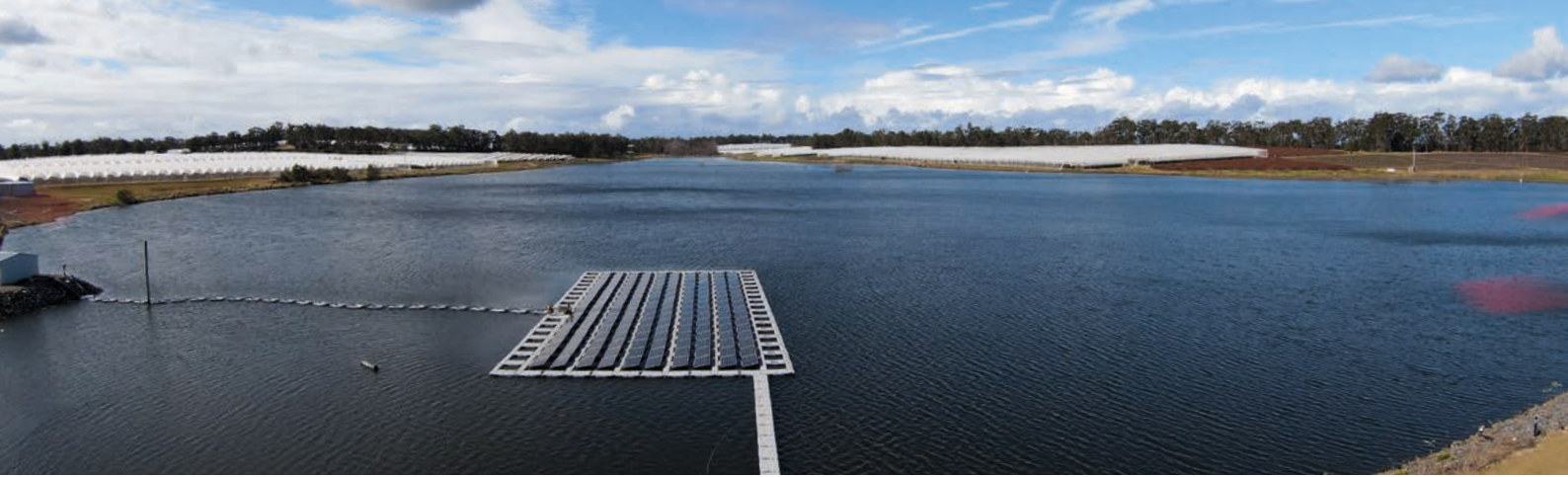
Corindi solar array
